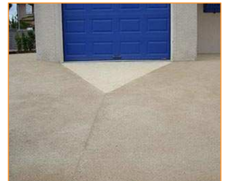
Béton poreux en entrée de garage
