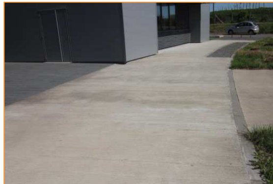
Noircissement du béton balayé sur une voie piétonne
