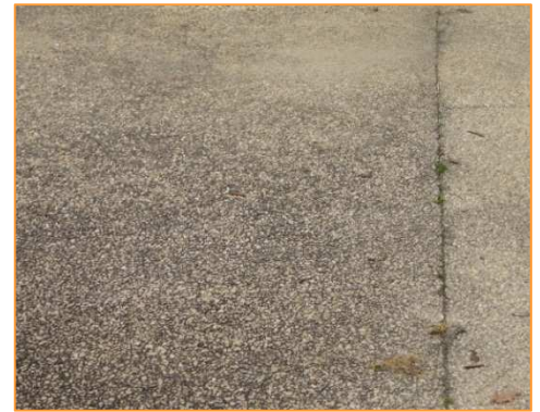
Béton désactivé - Noircissement du revêtement - Perte d'éclat - Développement de végétaux
